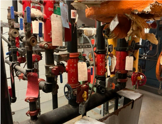
37 - FIRE SPRINKLER RISERS
